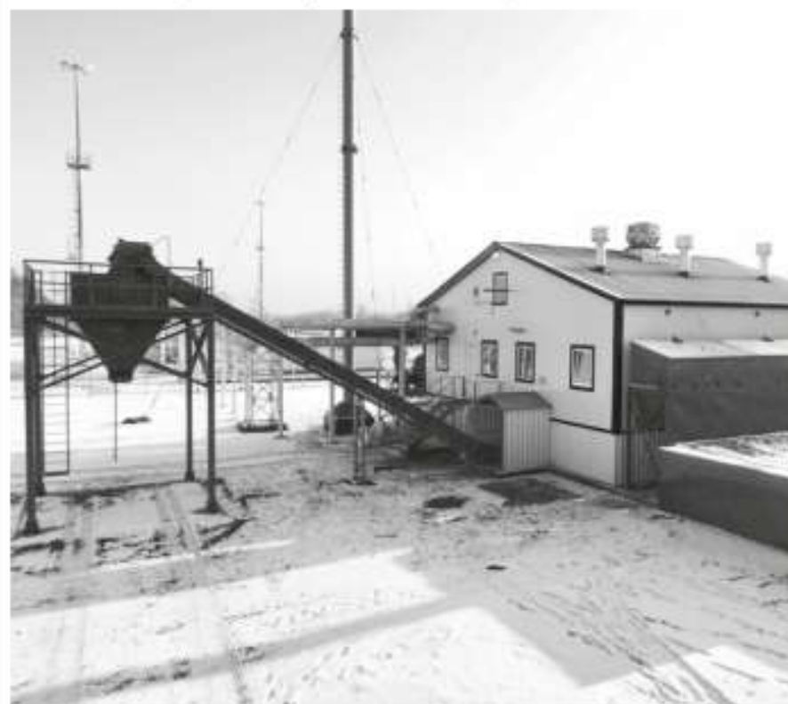
Паро-водогрейная котельная установка БМПКУ-3,0 МВт
